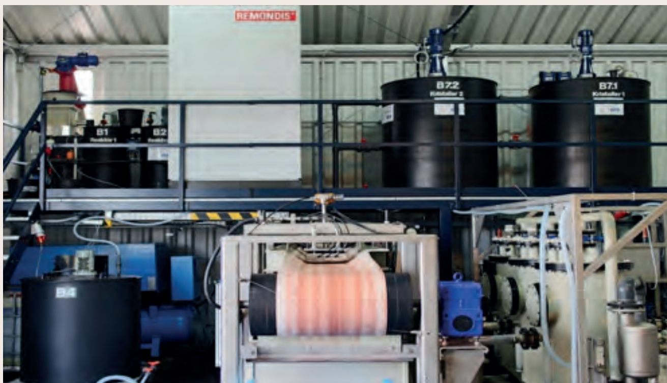
Abbildung 43: Remondis TetraPhos®-Pilotanlage bei HAMBURG WASSER
